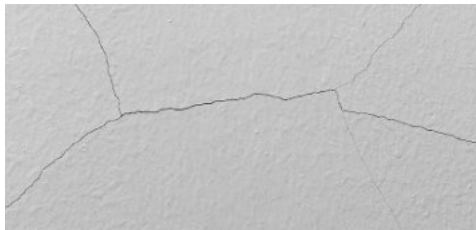
Risse im Putz an der Außenwand des FreiRaums
